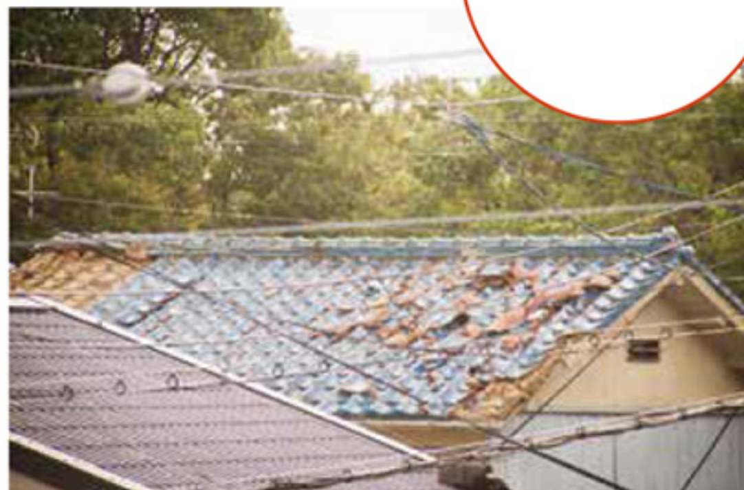
屋根瓦の被害
